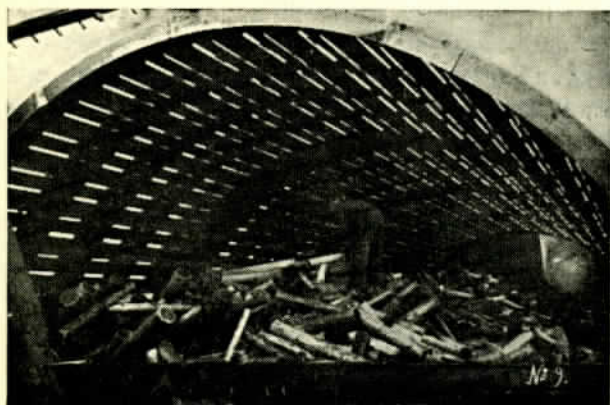
Rumpu sisältä. Taka-alalla näkyy puiden syöttöaukko.
