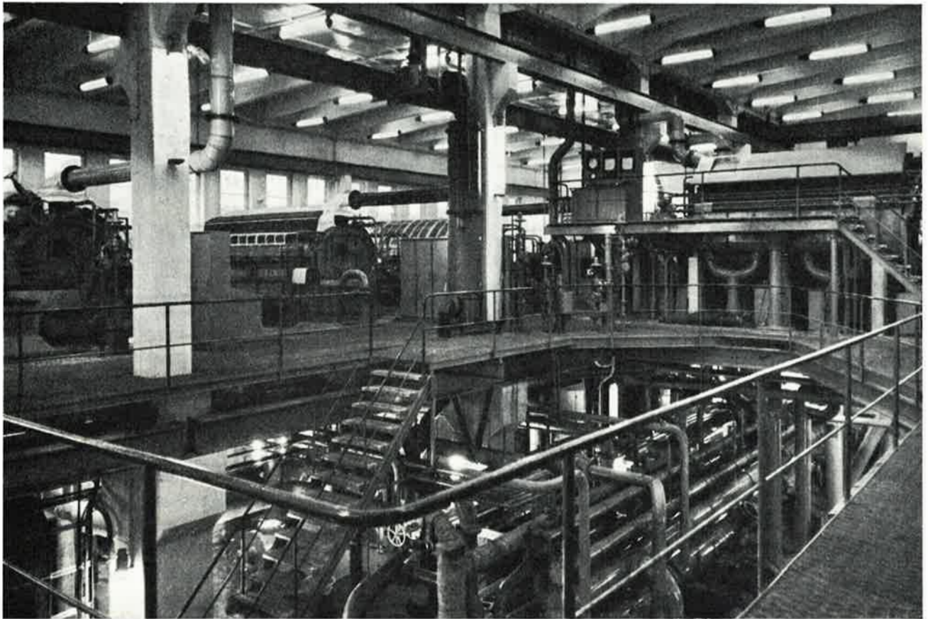
Näkymä uusitun valkaisuulinjan hoitotasolta Taustalla pesureita ja hoitotason alapuolella pesurikerroksen putkistoa
