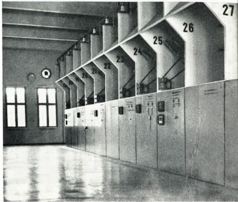
Voikan sähkönjakoaseman 20 kV:n asema
