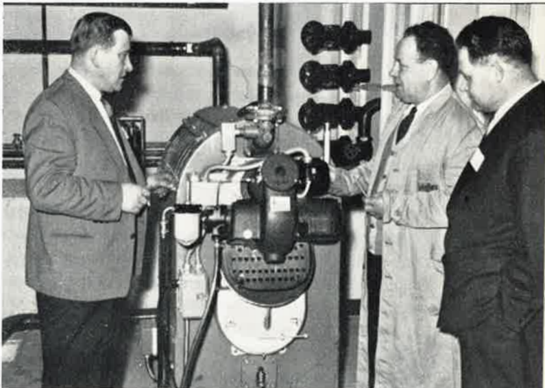
Komeita miehiä ja komea kattila: ylikonemestari Jussi Aho (kesk.) tutustuttamassa kurssilaisia Termis 110 öljynpolttimeen ja Heureka-kattilaan
