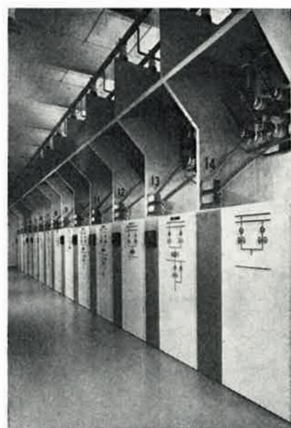
Osa uuden puolen 20 kV:n kojeistoa
