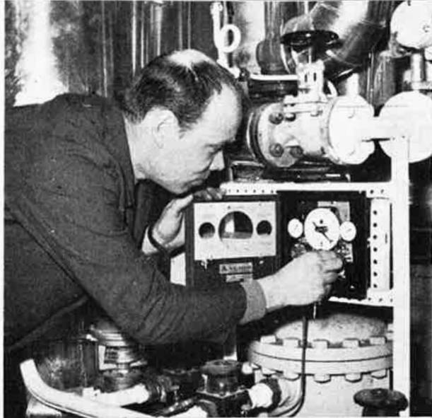
Reijo Hasu vastaa keskuspesulan kojeiden ja laitteiden kunnosta
