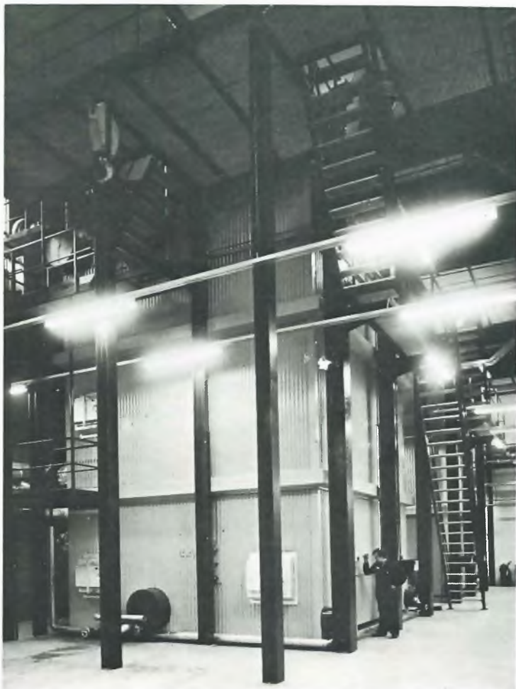
150 MW tehoinen lämpölaitos luovutettiin viime joulukuussa Uppsala Kraftvärme Ab:lle Ruotsissa. Kattilalaitoksessa on kolme kuvassa näkyvää Högfors-55 vesiputkikattilaa.
