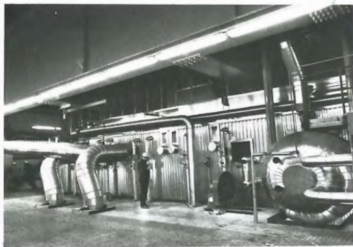
Näkymä kattilalaitoksen ylimmästä kerroksesta, oikealla höyryn kehittämiseen käytettävä ylälieriö.
