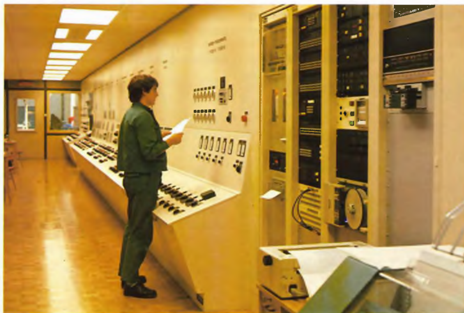
Uuden koneen valvontatilat on erotettu äänieristetyin seinin varsinaisesta konesalista. Etualalla Strömbergin toimittama SACO-konehälytysjärjestelmä, jota aiemmin on sovellettu vain laivojen konehuoneiden ja voimalaitosten valvontaan.
