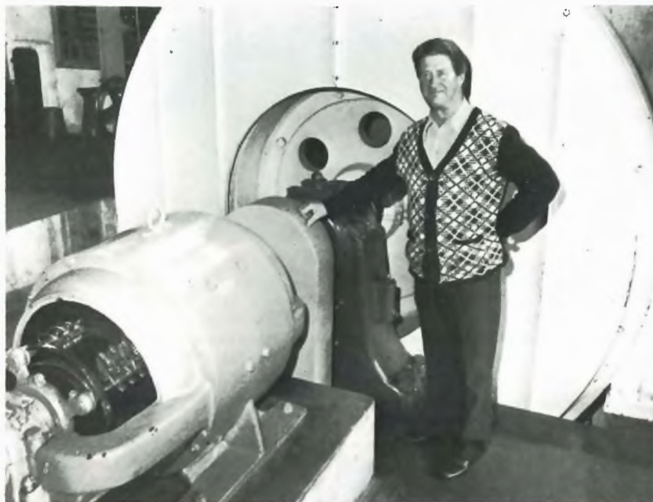
Kuvassa etumies Viljo Ruhanen esittelee varsinaisessa tehdasrakennuksessa sijaitsevaa kakkosturbiinia. Ykkösturbiini, joka sijaitsee eri rakennuksessa, seisoi kuluneena kesänä kolmen viikkoa veden vähyiden ja huoltotöiden takia.
