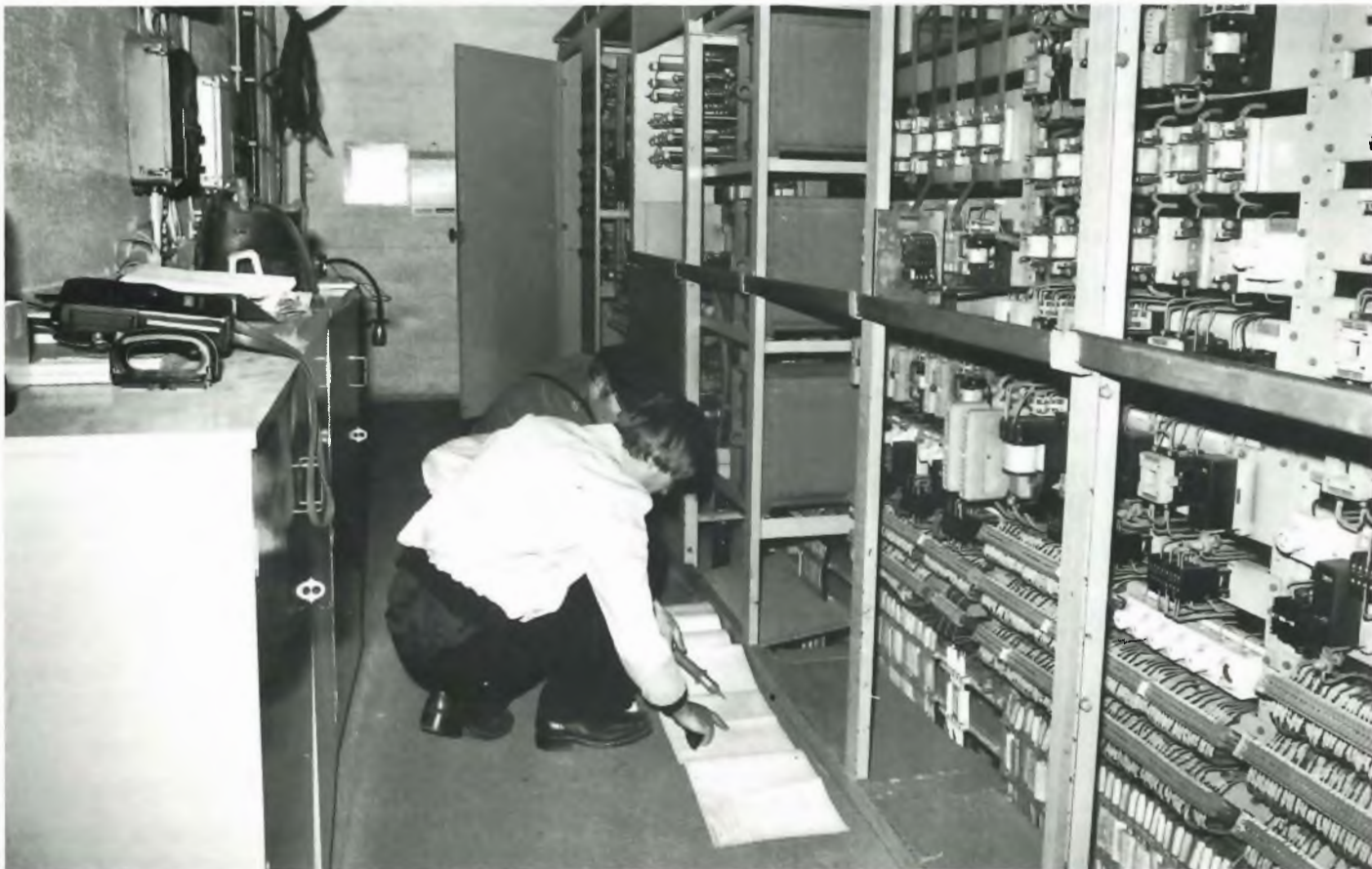
Tässä vaiheessa vikaa vielä etsitään kuumeisesti. Konepiirroksot levitetään lattialle avuksi. Miehet epäilevät viaksi palanutta sulaketta. Vika löytyi kuitenkin magnetoinnin apukontaktorista, joka ei laskenut virtaa läpi. Tällä kertaa vian vuoksi pysähtyneellä kuivauskoneella ei syntynyt hankaluuksia, sillä kone oli lämmitysajossa eikä massa ollut päällä.
