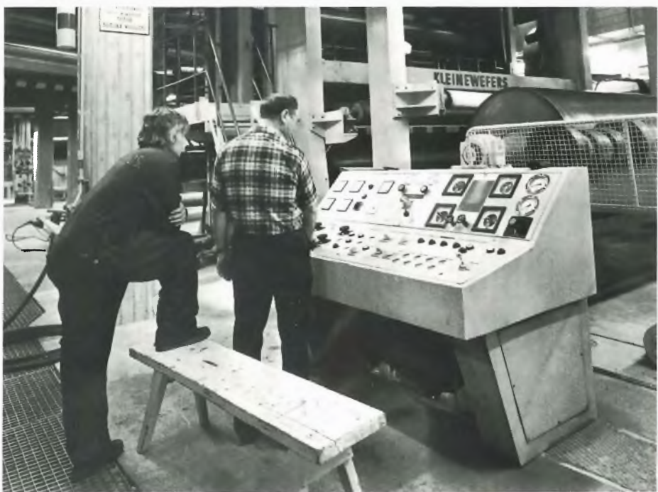
Vuorosähköasentaja Jari Niemi ja ajomies Viljo Nikki PK 7:n kiillotuskalanterin käynnistyspuuhissa. Samalla hetkellä kun konetta yritetään käynnistää, palaa sähkötaulusta sulakkeita.
