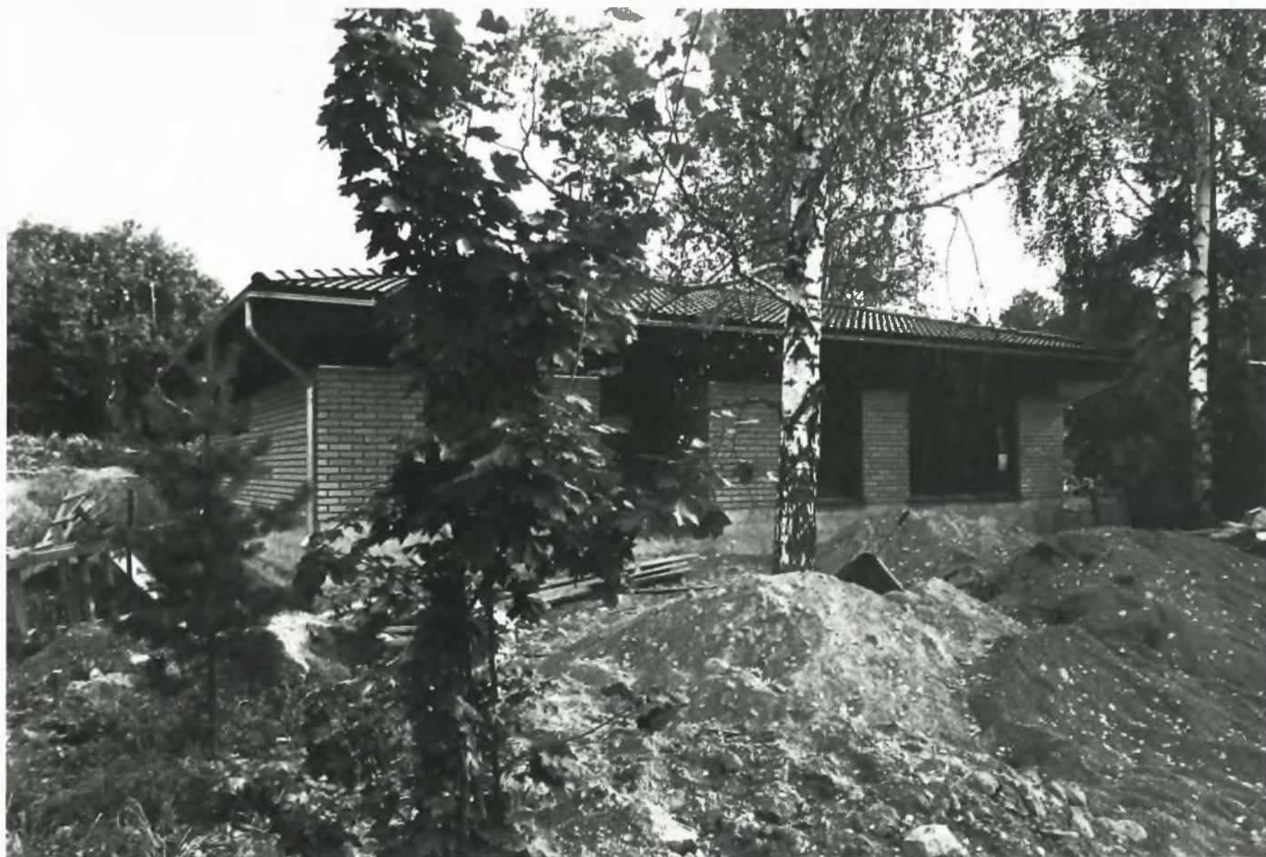
Aitaloiden omakotitalon ulkokuori on valmis. Syksy kuluu sisätöissä ja sisustuksen suunnittelussa. Perheen tavoitteena on päästä jouluksi omaan kotiin. Viimeistelytöt ja pihamaan kunnostus jäävät ensi vuoden puolelle.
