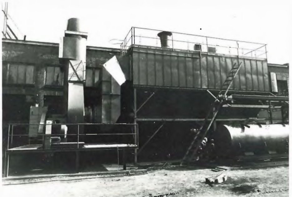
Kymin Metallin Karkkilan valimon uudella poistoilman puhdistajalla eli pölynerottimella saadaan talteen aiemmin ympäristöä likaamaan päässeet aineet. Laite on ns. kuivaerotin, joka huollon kannalta on aikaisempaa lietettä tuottanutta edullisempi.
