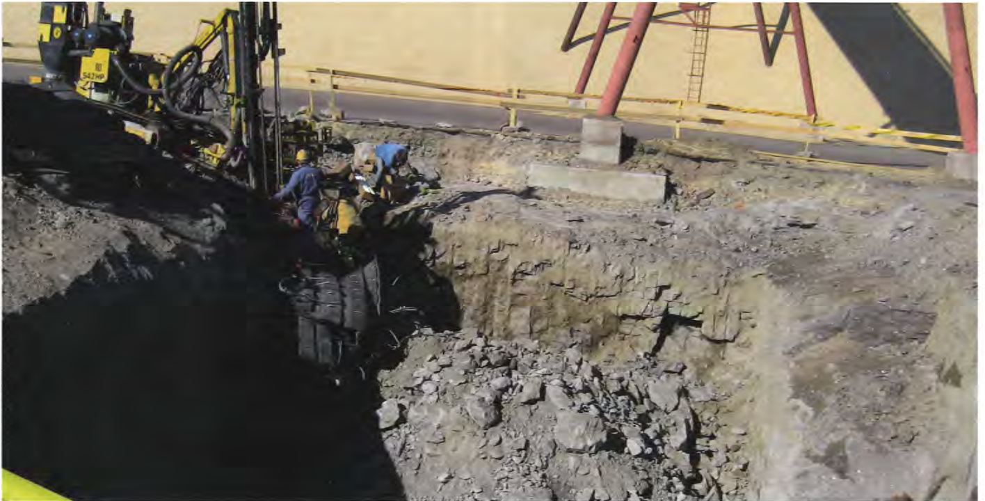
Uuden haketaskun louhintatyöt aloitettiin 19.5., ja vieressä olevan kuorimorakennuksen takana liettämön perustusten kaivuutyöt 13.6.
