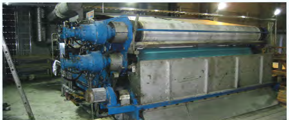
Kuvassa Espi-suotonauhapuristin, joka on siirretty uuteen lietteenkäsittelyhalliin. Sellutehtaan jätevesilaitokselta kuorimolle pumpattu bioliete puristetaan kahden viiran välissä polttokelpoiseksi, minkä jälkeen se menee Kymän Voimalle polttoon.
