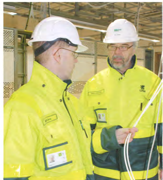
Kuvassa projektipäällikkö Eero Ahonen (oik.) ja järjestelmäpäällikkö Matti Ore tarkastelevat automaatiolaitetiloissa kaapeleita. ”Langat käsissä, homma hanskassa”, naurahtaa Eero.
