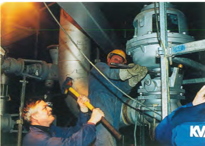
Päävaroventtiili jouduttiin avaamaan ja lukitsemaan uudelleen painekokeen alkuvaiheessa (kuva yllä).
