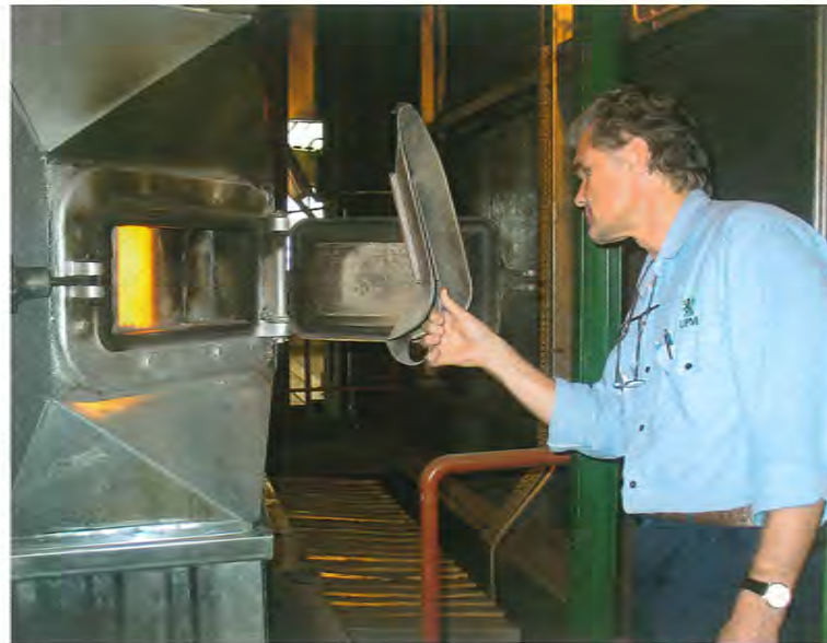
Voikkaan höyryvoimalaitoksen polttokattilassa jätteet muuttuvat energiaksi 850 asteen lämpötilassa. Tilannetta tarkkailee Sakari Ahola.
