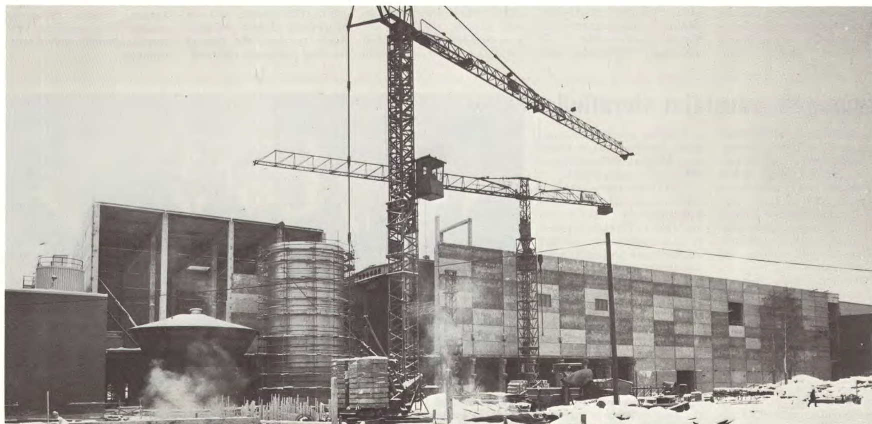
PK 8:n konehallin osalta runkorakenteet ovat valmiit ja elementeistä on asennettu 95 prosenttia.
