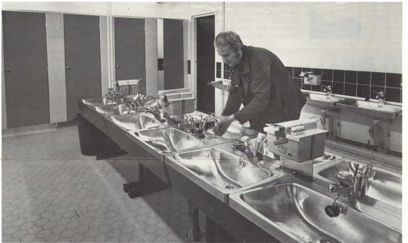
Sähköasentaja Matti Jarva on jo kuukauden päivät käyttänyt PK 7-8:n korjaamon uusia sosiaalitiloja.
