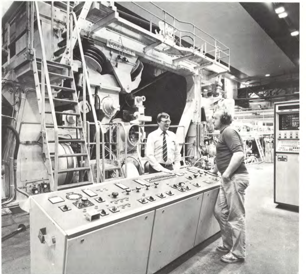
Käyttöinsinööri Esa Kallio (vas.) ja koneenhoitaja Eero Kivimaa uudistetun puristinosan edessä. Myös etualalla oleva ohjauspultti on uusi.
