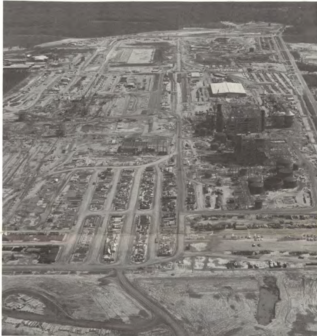
Leaf River Forest Products-yhtiön sellutehtaan rakentaa "avaimet käteen" -periaatteella amerikkalainen Brown & Root, Inc. Vasemmassa yläkulmassa näkyy alueelle aiemmin rakennettu saha.
