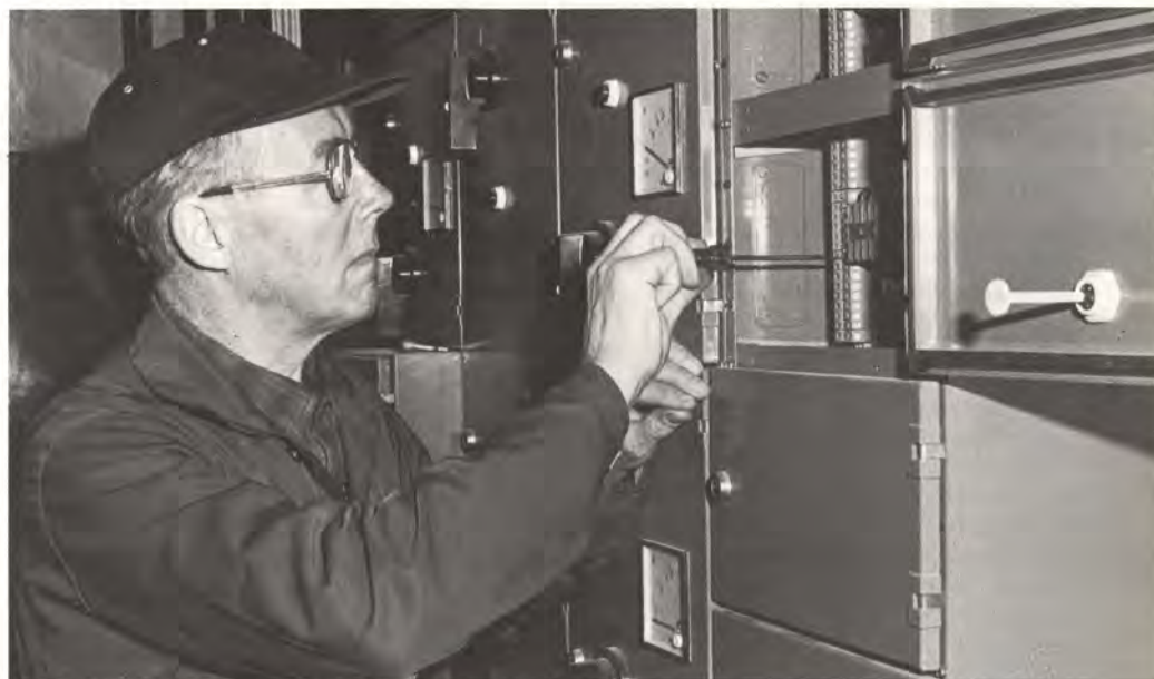
Olavi Simonen toimii sähkömiehenä klooritehtaalla.
