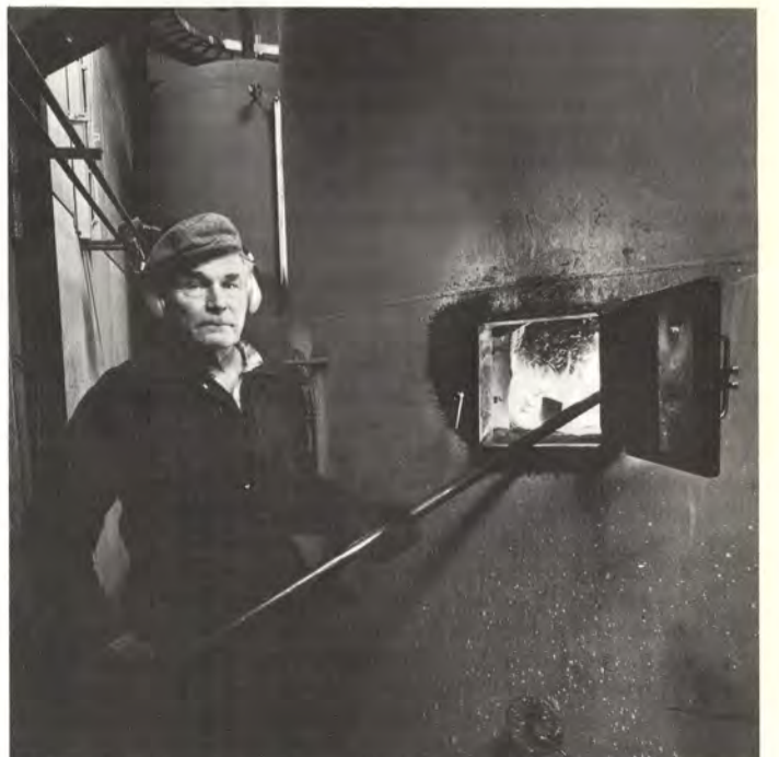
Olavi Kärkkäisen työhön lämpökeskuksen hoitajana kuuluu kuorikattilan toiminnan seuraamisen lisäksi monia muita tehtäviä.
