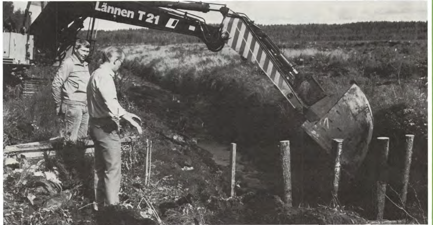
Rumputyö käynnissä Kiikunsuolla. Kiikunsuon tietyöt ovat vielä alkuvaiheessaan, toteavat tuotantopäällikkö Ensio Erkinharju (oik.) ja kenttämestari Niilo Hartikainen. Ojitus on piiri- ja lohko-ojien osalta valmis ja sarkaojitusta jatketaan roudan tultua.
