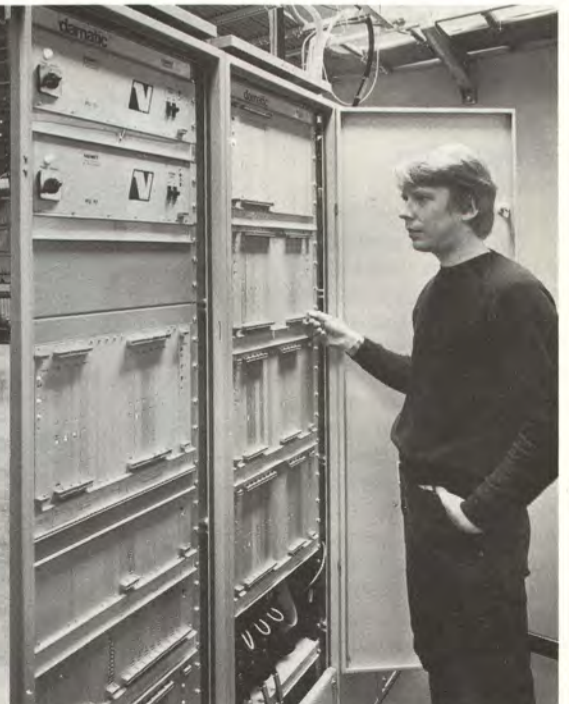
Damatic-kaapisto sisältää osan järjestelmän tarvitsemasta elektroniikasta. Laitteita esittelee työnjohtaja Mikko Lehtonen.
