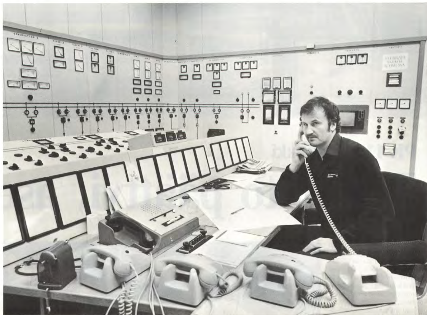
Kuusankosken tehtaiden sähkönjakelu on keskitetty Kuusankosken vesivoimalaitoksen keskusvalvomoni päivystäjälle.
