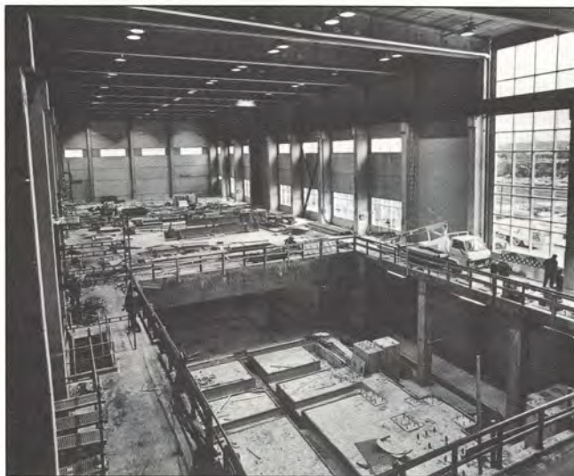
PK 18:n kuivaan päähän nousseeseen uuteen tehdasrakennukseen sijoitetaan pituusleikkuri ja superkalanteri nro 1.
