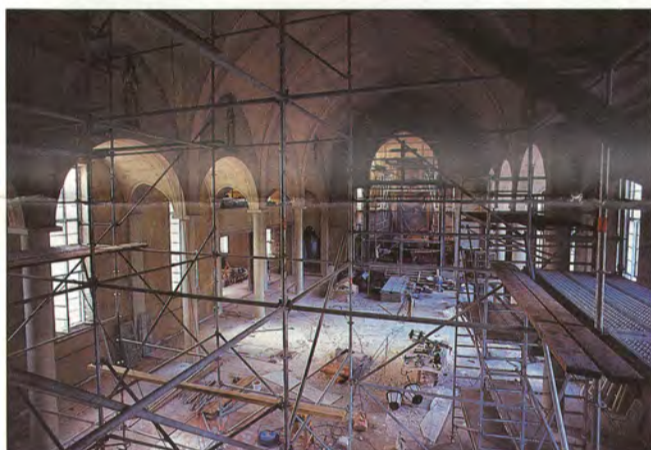
Kirkon ulko- ja sisäpinnat korjattiin ja maalattiin uudelleen. Työssä pyrittiin alkuperäisiin värisävyihin. Kuva viime elokuulta.
