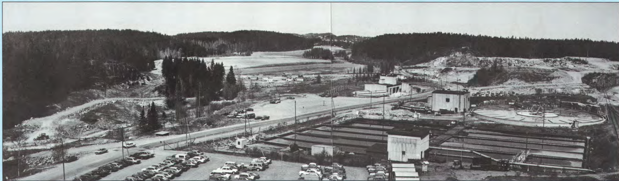
Biologisen puhdistamon rakennustyömaalta (takana oikealla) louhittu kiviaines käytetään pääasiassa Kuusanniemen puukentän laajentamiseen. Osalla täytetään kuvassa vasemmalla nähtävää kanjonia.
