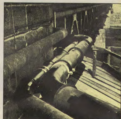
Massaputket ylittävät Kymiöjen tehtaan siltaa myöten Voikkaalla.
