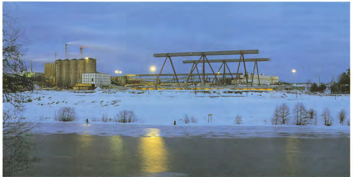
Tammikuun puolivälissä asennettiin paikalleen oikealla näkyvät hakekasojen kasasillat. Niiden kuljettimet jakavat hakkeen halutuille paikoille hakekasoihin.
