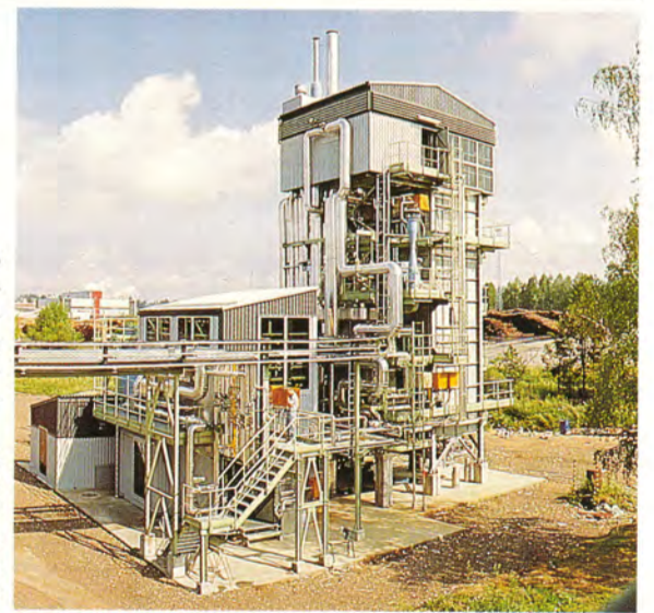
Uuden vetylaitoksen tuotantokyky on noin 1500 normaalkuutiometriä vetyä tunnissa.
