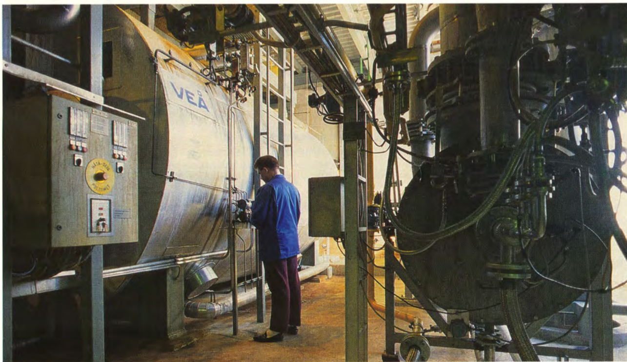
Hajukaasut hävitetään polttamalla hajukaasukattilassa, jonka pääpoltoaine on metanoli. Kattilassa otetaan talteen lämpö ja poistuvat savukaasut pestään erillisessä pesurissa. Vasemmalla hajukaasujen polttokattila, oikealla häiriö- ja korjaustilanteissa käytettävä varapoltin, jossa hajut hävitetään kuten varsinaisessa poltossa, mutta lämpöä ja rikkidioksidia ei oteta talteen.
