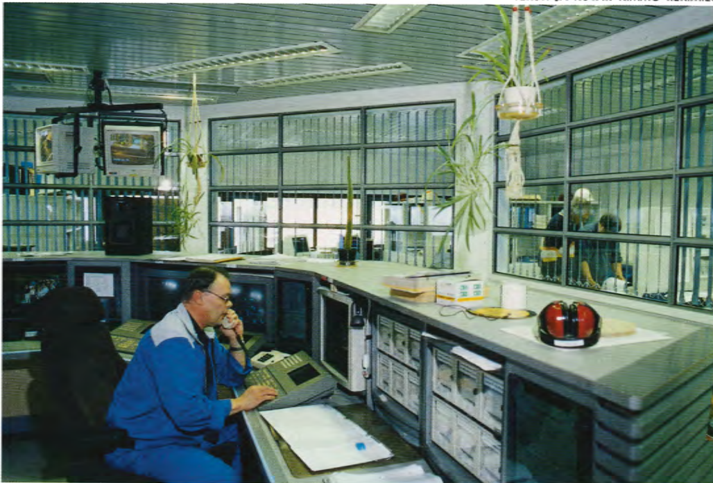
Tilat uusia konttoreita ja neuvotteluhuonetta varten vapautuivat, kun kuitulinjan vanhat ohjauspaneelit voitiin purkaa ohjausjärjestelmän uusinnan jälkeen.
