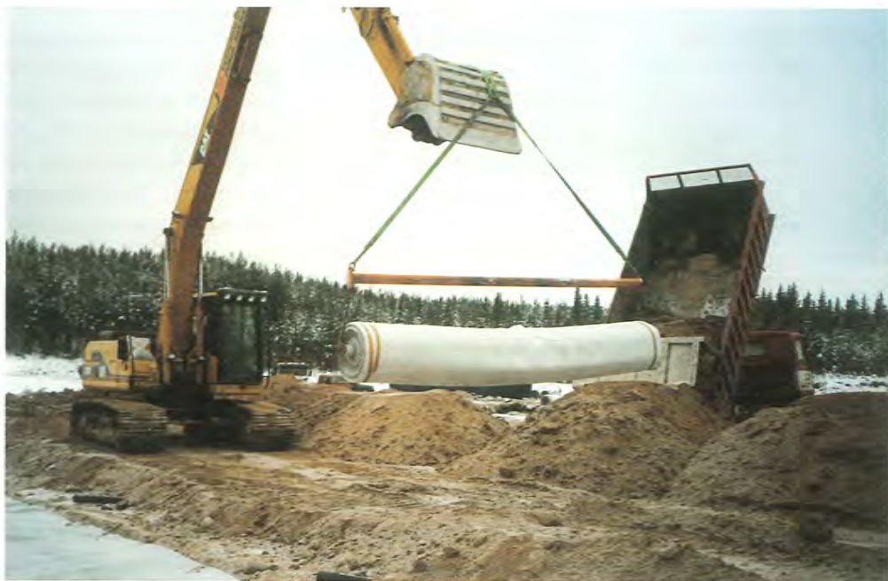
Ohuen, alle 3-metrisen, saven alueilla ja reuna-alueilla on käytetty keinotekoisena eristeenä bentoniittimattoa, jota tarvittiin yli 7000 neliometriä. Matto estää suotovesien imeytymisen maaperään.
