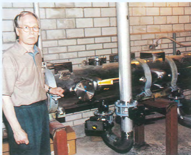
Kuivauskoneen tiloihin asennettua suodatinta esittelee suunnittelija Raimo Motturi.
