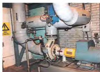
Mittauslähetin (vas. putken kyljessä), säätöventtiili (sininen) ja pumpun valvontayksikkö (etualalla).
