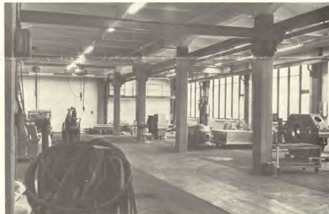
Santasalon konepajalle kunnostetaan Karkkilassa tehdashalleja. Uutta vierintäjyrsinkonetta varten on valettu yli kaksimet- rinen betonilaatta.
