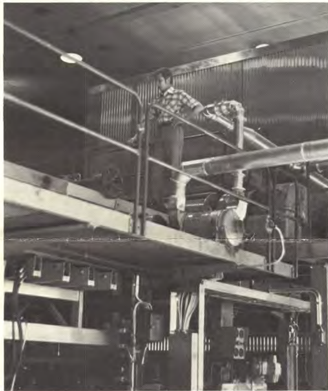
Uudistusprojektin vetäjä dipl.ins. Anssi Vesanen esittelee peruskorjattua konetta. Lämpötila salissa laski tehtyjen parannusten ansiosta.
